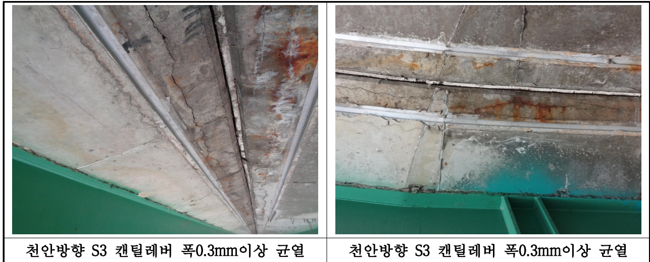
【사진 7.1】 바닥판 균열(폭 0.3mm이상) 발생 현황
